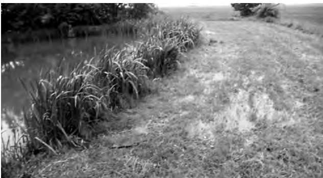
Gefahr für Wetzdorf – der Braunsdorfer Teich fließt über die Dammkrone ab.
